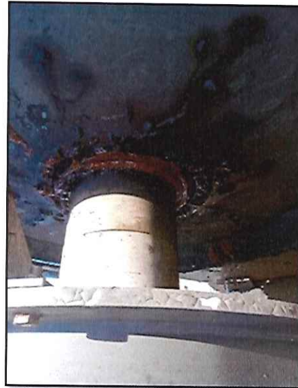
Local: Torre Item # 46: polias da torre sem a vedação de proteção do rolamento.
