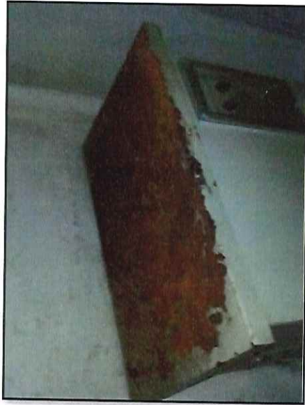
Local: Sala Elétrica Item # 44: corrosão sobre o painel do banco de resistência.
