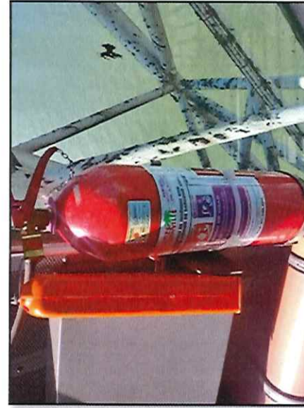
Local: Cabine Superior Item # 61: extintor de incêndio da cabine do operador está preso com abraçadeiras plásticas.
