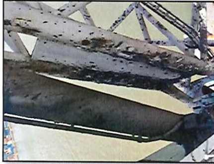
Local: Lança Item # 52: excesso de graxa na base da lança, próximo ao cilindro de elevação.
