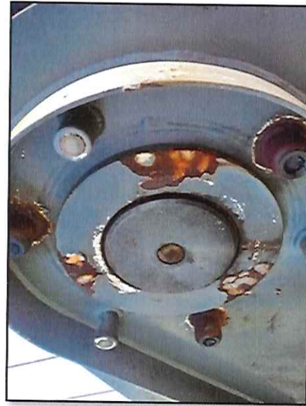
Local: Torre Item # 46: pontos de corrosão na estrutura das polias da torre.
