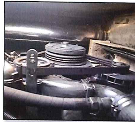
Local: Sala de Máquinas Item # 15: proteção da correia do motor diesel está desmontada.
