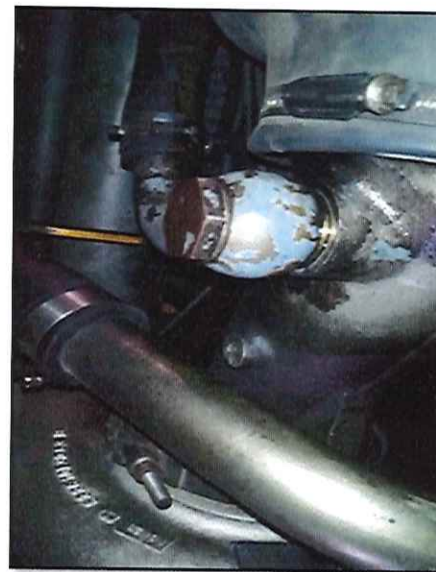
Local: Sala de Máquinas Item # 15: necessário trocar as juntas do coletor de escape do motor diesel.
