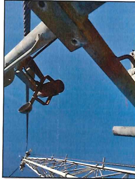
Local: Torre Item # 49: pontos de corrosão no suporte do anemômetro (obs: anemômetro funcionando normalmente).
