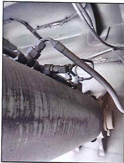
Local: Estrutura Rodante Item # 03: pequenos vazamentos de óleo hidráulico nas conexões dos cilindros de articulação das patolas.
