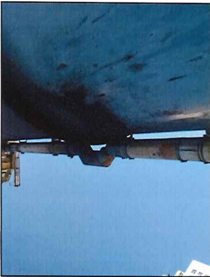
Local: Torre Item # 51: escapamento do motor diesel furado na parte externa da torre. Status: corrigido.
