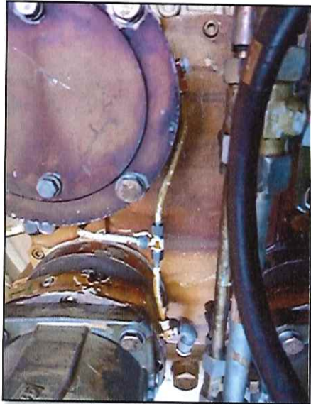
Local: Sala do Guincho Item # 25: pequenos vazamentos de óleo na tubulação dos freios do dromo de carga pesada ( heavy duty ).
