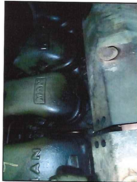
Local: Sala de Máquinas Item # 15: vazamento de óleo pelas tampas de válvula do motor diesel.
