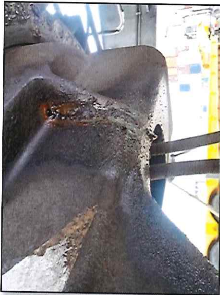
Local: Estrutura Rodante Item # 02: vazamento de óleo hidráulico em diversos eixos de movimentação (trucks).
