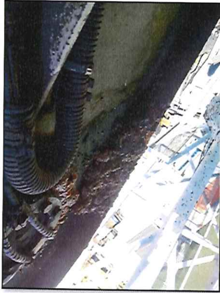
Local: Torre Item # 46: excesso de graxa nas polias fixas da torre do guindaste.
