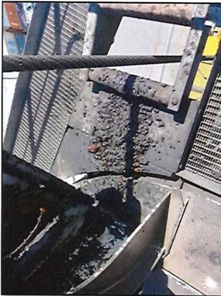
Local: Torre Item # 51: passarela ao redor das polias da torre com excesso de graxa.
